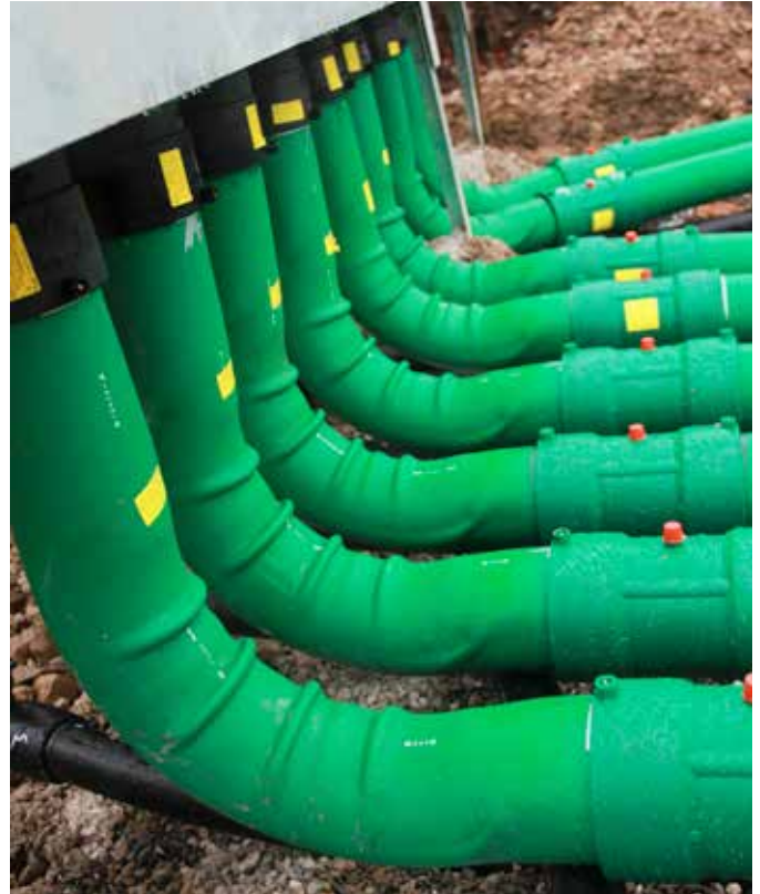
KPS bends below fill point
